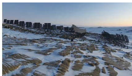
<太陽光パネル>
