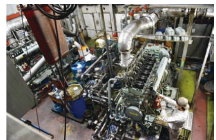
<ディーゼル発電機300kVA> ※メンテナンスに備え2台設置
